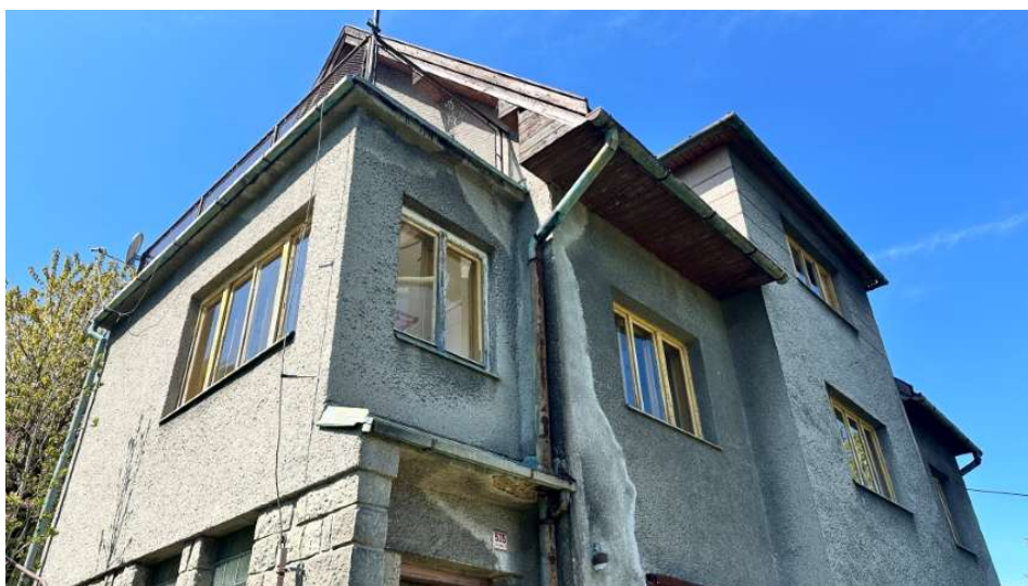
Foto 58: Pohled na stopy po zatékání na fasádě předmětného objektu.
