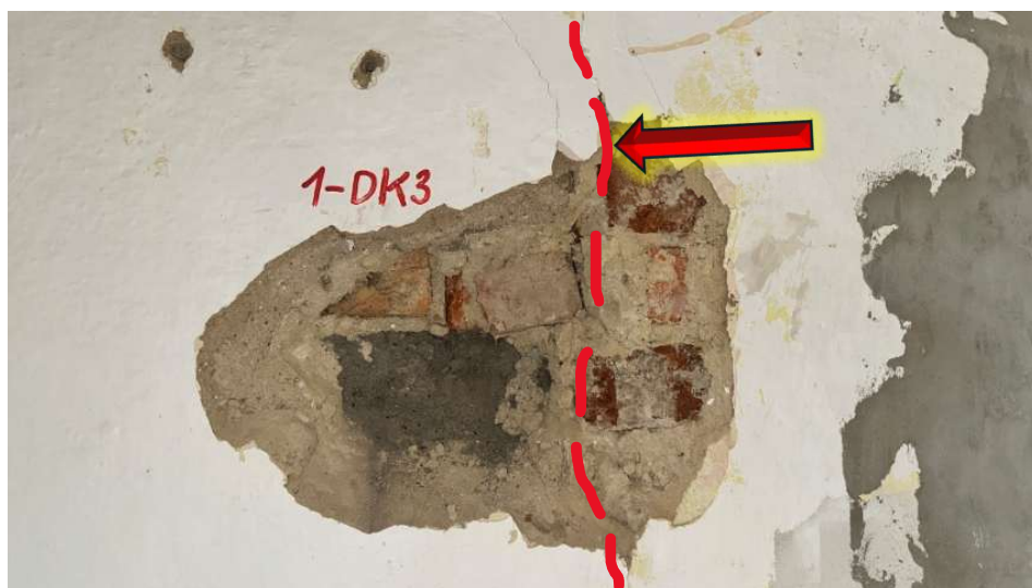
Foto 57: Pohled na provedenou sondu 1-DK3. Svislá trhlina v omítkce kopíruje tvar svislé neprovázané spáry zdiva. Vizuálně odlišné stavební materiály mezi jednotlivými částmi.
