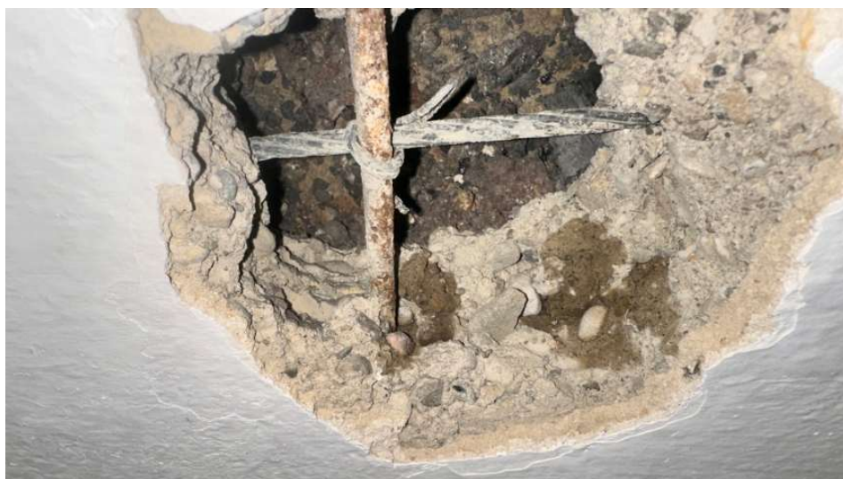
Foto 39: Pohled na odhalené vyztužení desky v místě křížení lana s prutem výztuže, patrný rozpad betonu.
