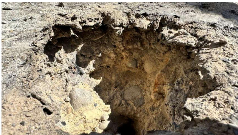
Foto 29: Detail degradované nosné ŽB konstrukce v místě sondy S1.
