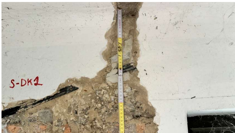
Foto 48: Pohled na obnažený železobetonový věnec v místě sondy S-DK2. Výška věnce je cca 340 mm.
