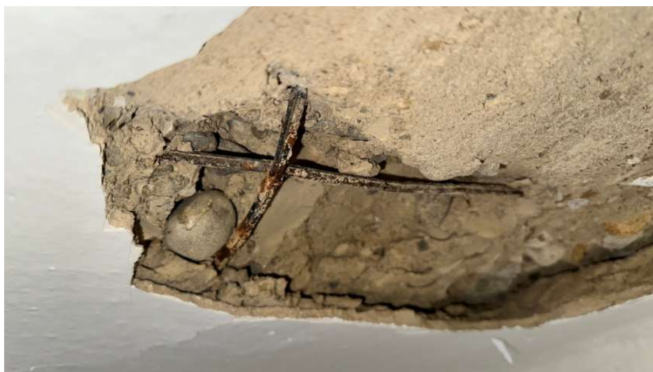
Foto 42: Detail degradované konstrukce, odpadávání spodní vrstvy konstrukce, použité nekubická zrna kameniva.
