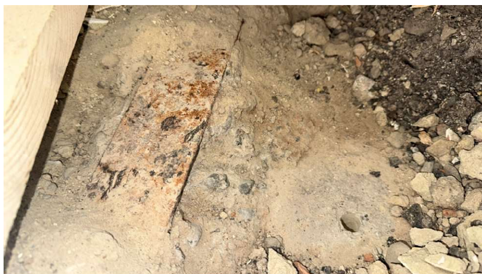
Foto 14: Pohled na horní část profilu IPN 120, profil opatřen obetonávkou horní příruba betonem nízké kvality.
