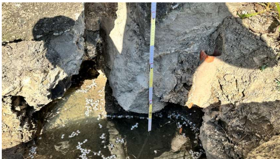
Foto 3: Pohled na nastoupanou hladinu podzemní vody do výšky cca 600 mm od úrovně přilehlého terénu.
