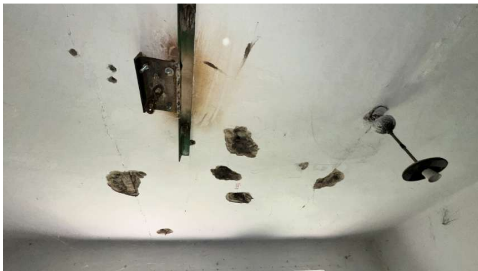
Foto 32: Pohled na místo sondy S-SS2. Viditelné trhliny podél okrajů jedné strany příruby IPN vychýlených profilů.
