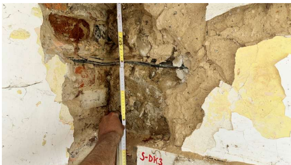
Foto 50: Pohled na provedenou sondu S-DK3. ŽB konstrukce je ukončena před zdivem příčné stěny z cihel plných pálených. V místě sondy zjištěna nižší kvalita betonu konstrukce nad vchodovými dveřmi.
