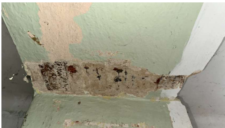
Foto 44: Pohled na obnaženou konstrukci průvlatu tvořenou dvěma profily IPN výšky 160 mm a šířky 66 mm. Mezi profily dozdvívka z cihel plných pálených. Šířka průvlatu cca 470 mm.
